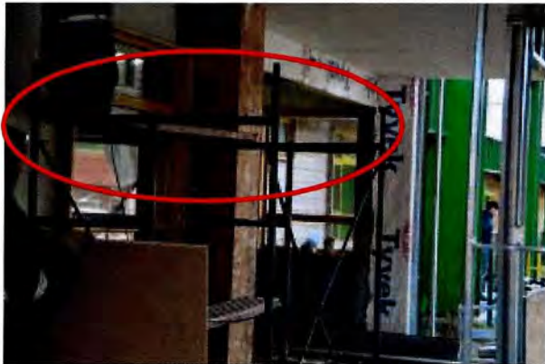
Fotografía N° 51: Plataforma no cumple con condiciones de seguridad, en Ampliación Prebásica Escuela Pioneros del Sur.
