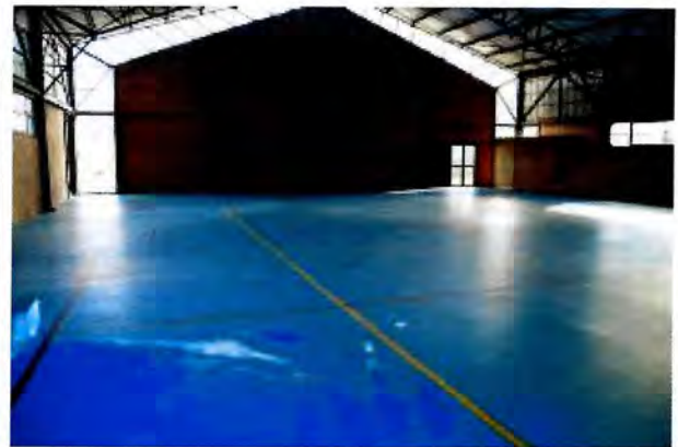
Fotografía N° 50: Falta de instalación de arcos deportivos en sala uso múltiple Escuela Pioneros del Sur.
