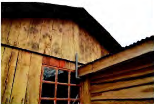
Fotografía N° 15: Tubería de ventilación caseta [REDACTED]
