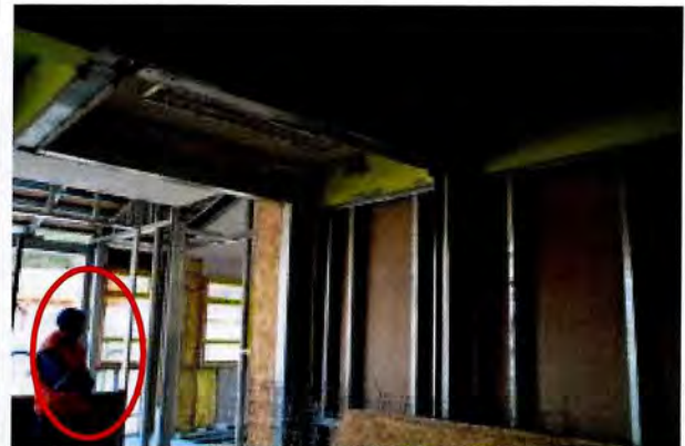
Fotografía N° 52: Trabajador sin casco de seguridad, en Ampliación Prebásica Escuela Pioneros del Sur.
