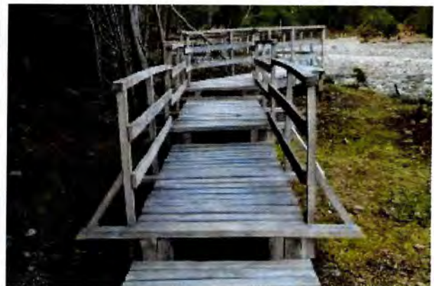
Fotografía N° 44: Falta de Vigas travesaño, en pasarela, Huella de Acceso Pasarela Peatonal Río Mosco.
