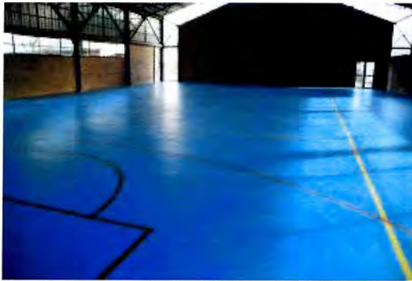
Fotografía N° 49: Falta de instalación de arcos deportivos en sala uso múltiple Escuela Pioneros del Sur.
