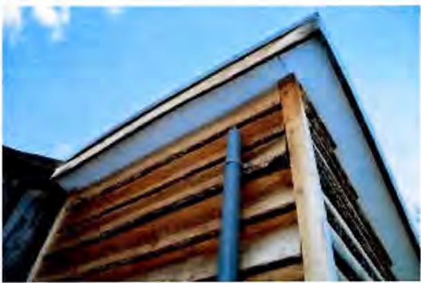
Fotografía N° 18: Tubería de ventilación caseta [REDACTED]
