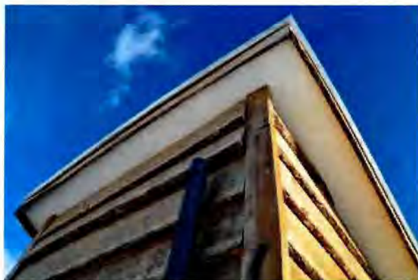
Fotografía N° 14: Tubería de ventilación caseta [REDACTED]
