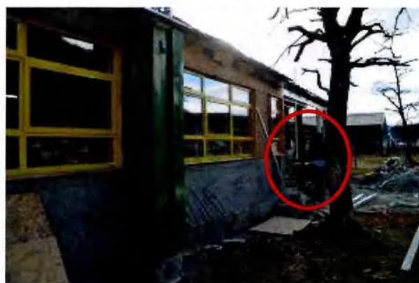
Fotografía N° 53: Trabajador sin casco de seguridad, en Ampliación Prebásica Escuela Pioneros del Sur.
