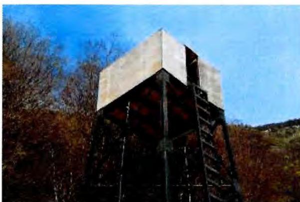
Fotografía N° 29: Ausencia de revestimiento plástico en estanques de Soluciones Sanitarias.
