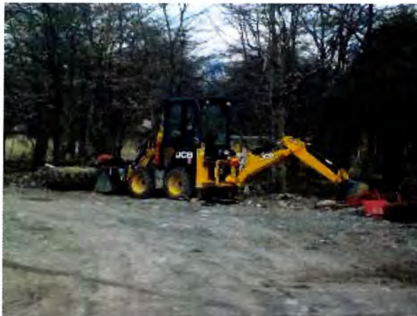
Fotografía N° 45: Ausencia de personal en obra, en zona Vertedero.
