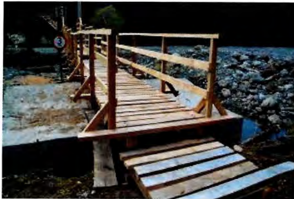
Fotografía N° 43: Falta de Vigas travesaño, en pasarela, Huella de Acceso Pasarela Peatonal Río Mosco.
