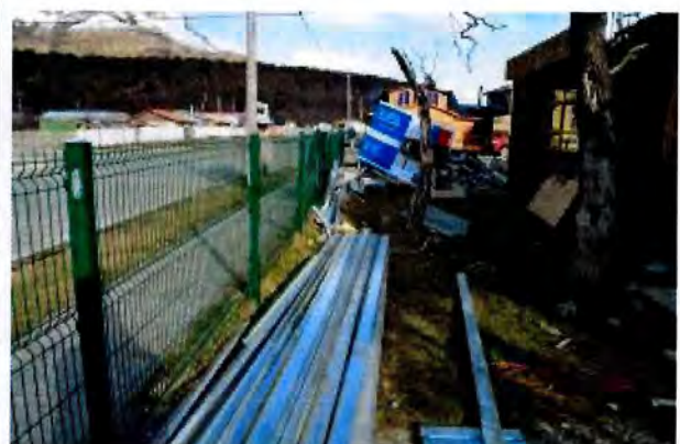
Fotografía N° 48: Falta de instalación de faenas en obra Ampliación Prebásica Escuela Pioneros del Sur.
