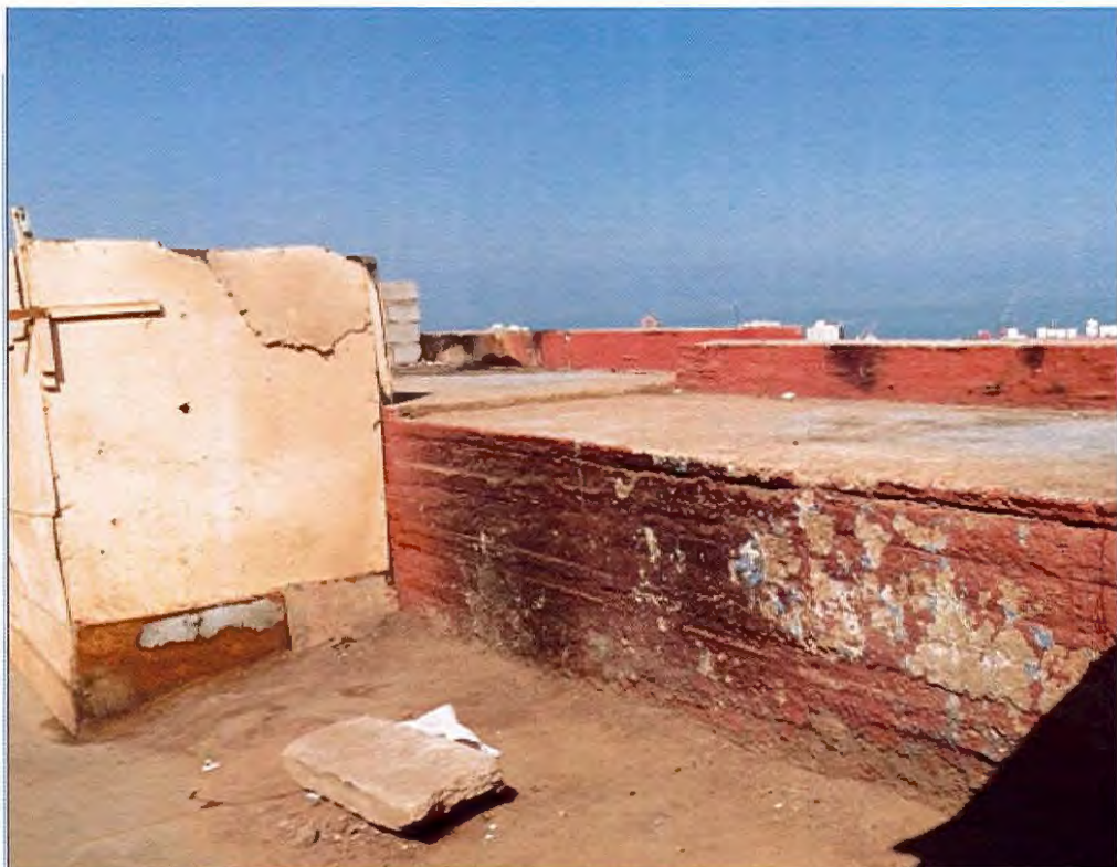
Fotografía N° 4: Muro con altura inferior a 2 metros en el sector de la pérgola.
