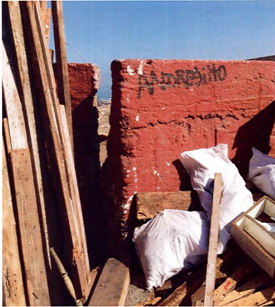
Fotografía N° 3: Muro perforado en el sector de la pérgola.
