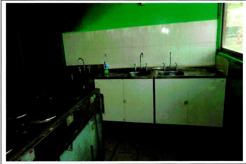
Fotografía N° 7, menos altura de superficie cerámico.
