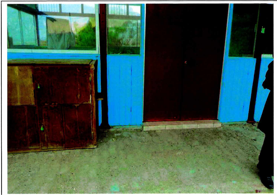
Fotografía N° 6, no se instalaron celosías en puertas.
