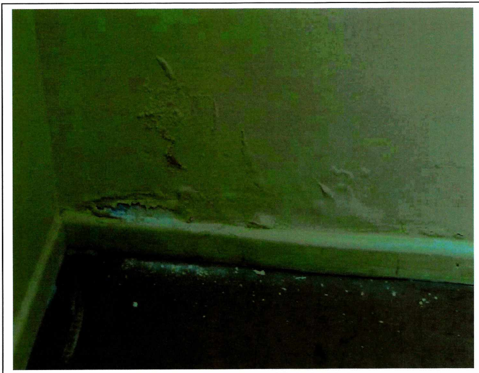
Fotografía N° 20, pintura soplada en muros. Módulo B.
