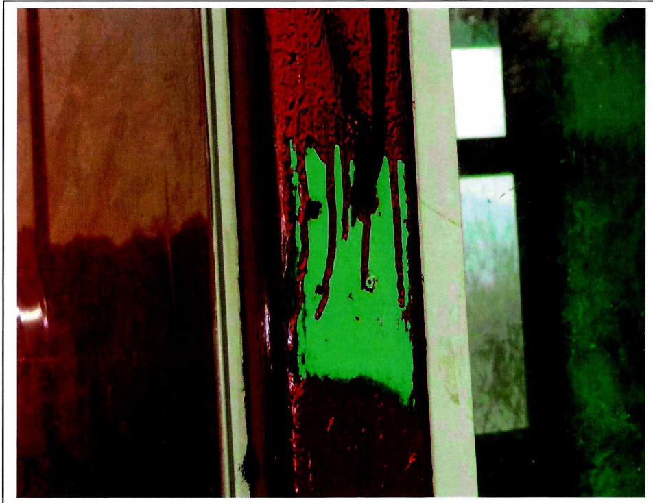
Fotografía N° 15, defectos en pintura interior.
