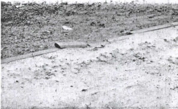
Fotografía N°11 Solerillas partidas, al norte del cruce de Quilín con Canal Las Perdices.
