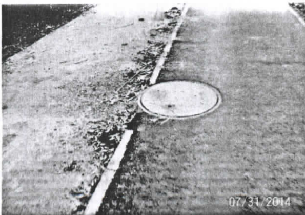
Fotografía N°5 Solerías faltantes contiguas a la cámara existente, entre José Arrieta y Valle Hermoso.
