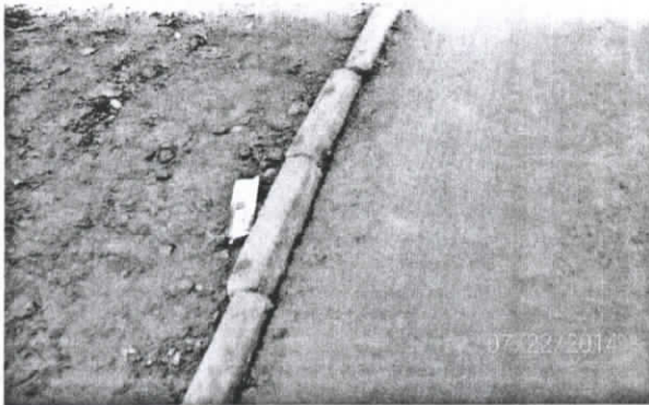
Fotografía N°9 Soleras desalineadas, al sur del cruce de Antupirén con Las Perdices.
