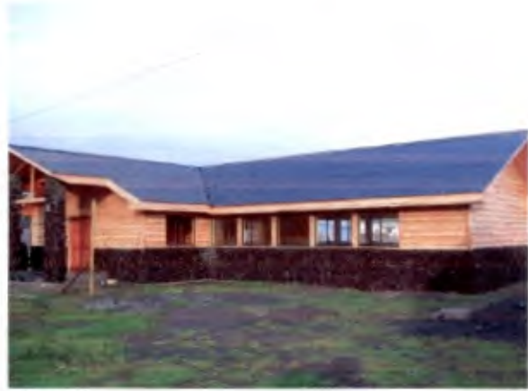
Foto 4: Const. Sede Comunitaria Reflejos del Lago Faltan canales y bajadas de aguas lluvia
