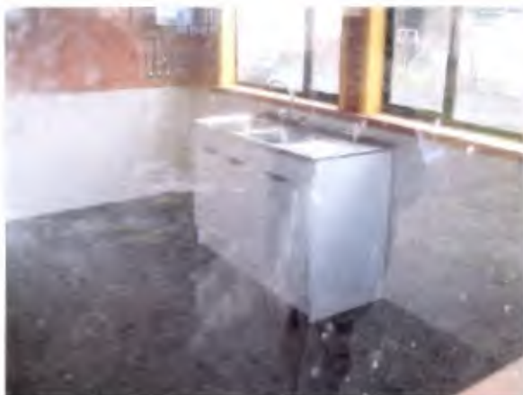
Foto 7: Const. Sede Comunitaria Reflejos del Lago Lavaplatos distinto al especificado
