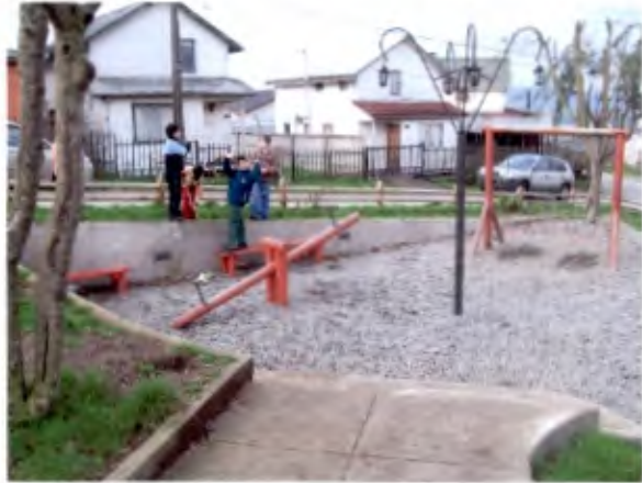
Foto 14: Construcción Plaza Villa Casino Faltan las solerillas de hormigón
