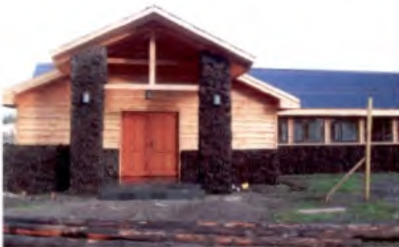
Foto 5: Const. Sede Comunitaria Reflejos del Lago Cerchas distintas a las proyectadas
