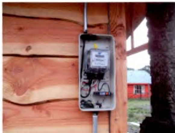
Foto 8: Const. Sede Comunitaria Reflejos del Lago Medidor eléctrico expuesto
