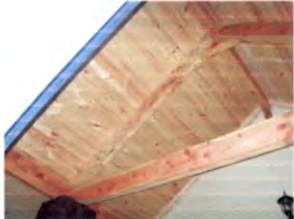
Foto 2: Const. Centro Comunitario en Nueva Braunau Cerchas distintas a las proyectadas
