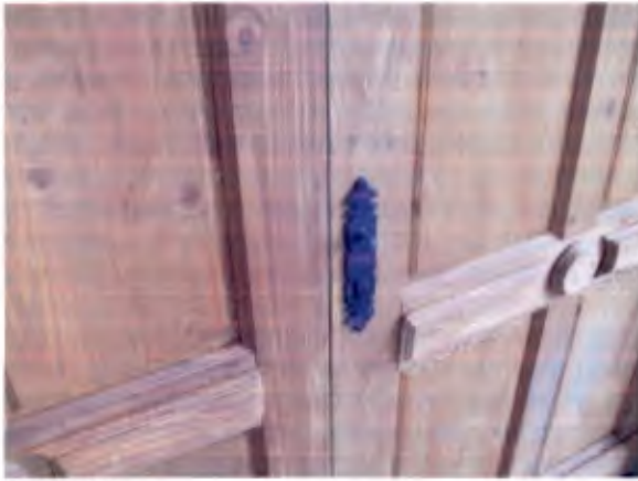
Foto 3: Const. Sede Comunitaria Reflejos del Lago Sin manilla de acceso y puerta trabada
