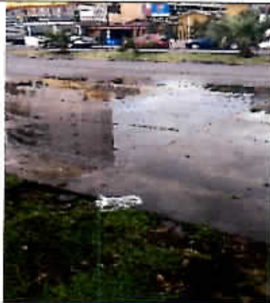
Fotografía N°15 - 06/06/2017 - Parque La Almeja Filtración de cañería en sector sur oriente.
