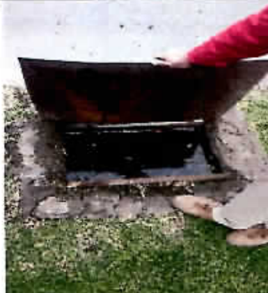
Fotografía N°23 - 09/06/2017 - Plaza Bicentenario Cámara de riego con filtración, sin aseo y tapa sin candado
