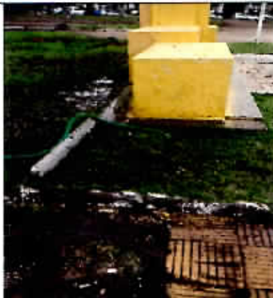
Fotografía N° 9 -06/06/2017- Parque Brasil Riego por inundación y escurrimiento de agua superficial en áreas duras y blandas
