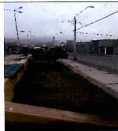
Fotografía N°28 - 09/06/2017 - Paseo María Elena Falta de pintura solera sector norte,
