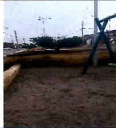
Fotografía N°26 - 09/06/2017 - Paseo María Elena Falta de pintura en solera sector norte
