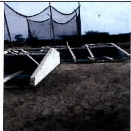
Fotografía N° 6 - 06/06/2017- Parque Juan López Abandono de Infraestructura deportiva sin uso, sector norte.
