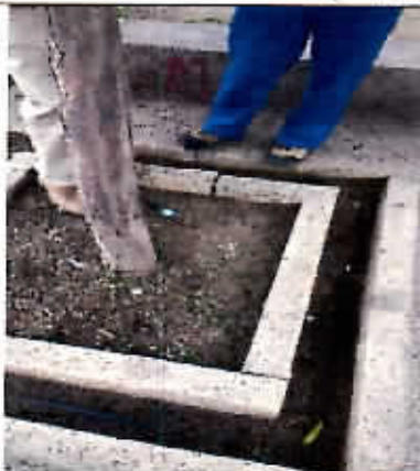
Fotografía N°17 - 09/06/2017 - Plaza Bicentenario Falta de dosificador de agua en sistema de riego de arbolado según ITS
