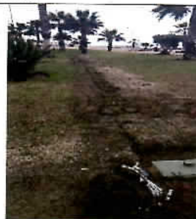
Fotografía N°16- 06/06/2017 - Parque La Almeja Instalación de sistema de riego automático deja en malas condiciones el césped
