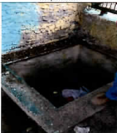
Fotografía N° 4 - 06/06/2017- Parque Juan López Cámara de riego sin aseo y tapa
