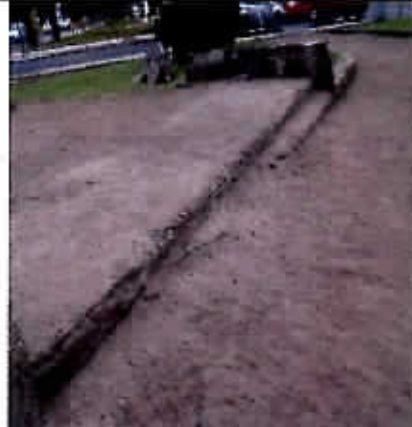
Fotografía N° 4 - 06/06/2017- Parque Brasil Escalera de hormigón en mal estado
