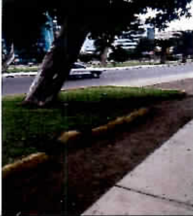
Fotografía N° 1 - 06/06/2017- Parque Brasil Solerillas en mal estado sector suroriente
