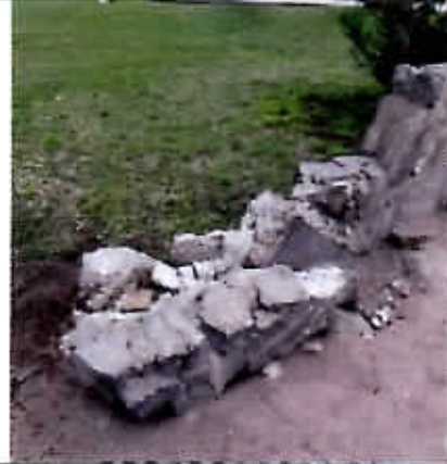
Fotografía N° 2 - 06/06/2017- Parque Brasil Mampostería de soleras en mal estado sector sur
