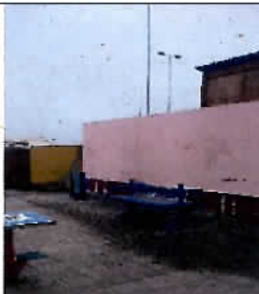
Fotografía N°30 - 09/06/2017 - Plaza Bicentenario Falta de pintura muro sector norponiente
