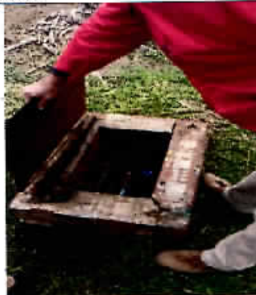
Fotografía N°20 - 09/06/2017 - Paseo Victor Farias Tapa de sistema de riego en mal estado y sin candado
