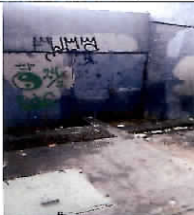
Fotografía N° 10-06/06/2017-Parque Nicolás Tirado Muro de contención con rayado de grafiti en sector oriente
