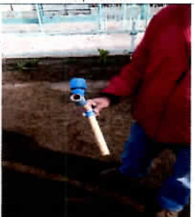
Fotografía N° 3 - 06/06/2017- Parque Juan López Válvula de riego conectada a tubo de pvc eléctrico y no hidráulico
