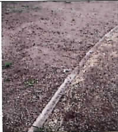
Fotografía N°19 - 09/06/2017 - Paseo Victor Farias Sistema de riego no operativo en sector jardineras
