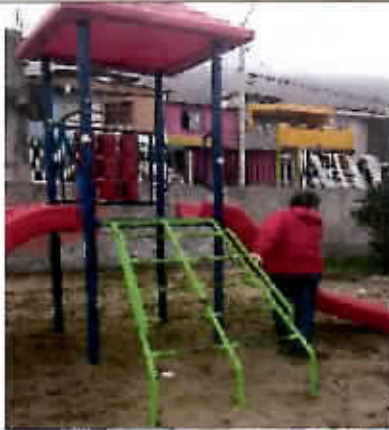
Fotografía N°24 - 09/06/2017 - Paseo Los Pumas Mal estado de pintura de juegos infantiles sector sur
