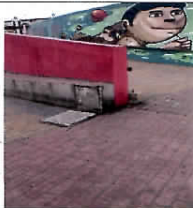
Fotografía N°17 -06/06/2017-Parque Nicolás Tirado Restos de escombros de solera en mal estado sector poniente.
