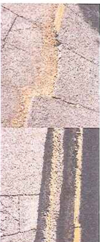
Pavimento y escalas dañadas
