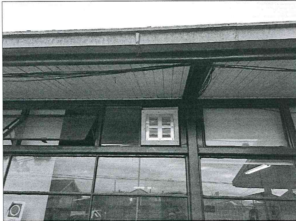
Fotografía 3: vista exterior ventilación, obra Conservación escuela Felipe Barthon Corbeaux.
