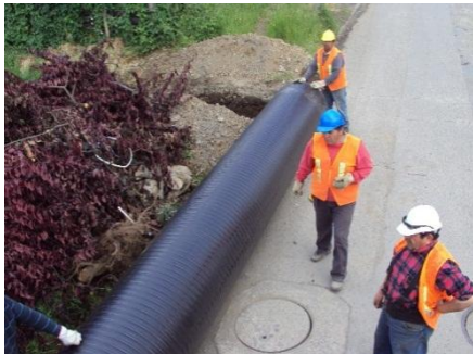
Nueva Tubería Utilizada
