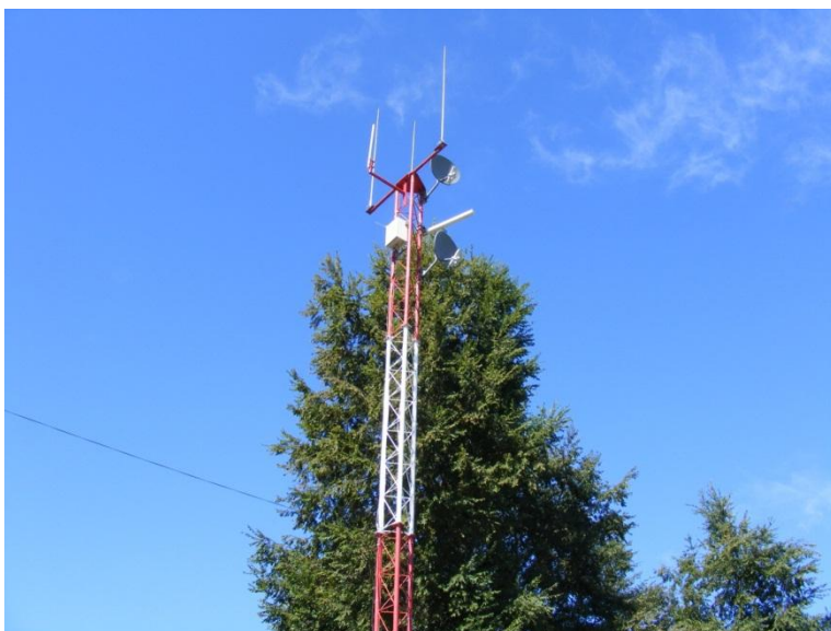
Antenas transmisoras enviando señal de internet hacia Coñaripe
