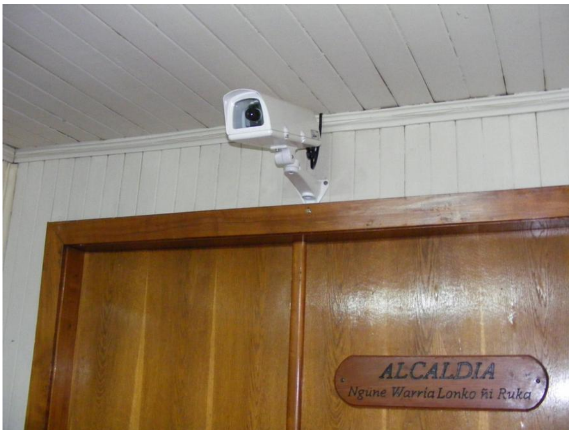
Instalación de cámara en pasillo Alcaldía Municipal
