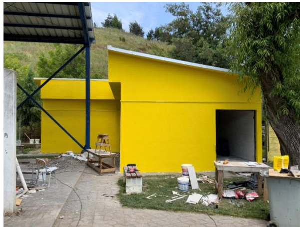
Ilustración 14: Después Sala mecánica industrial
