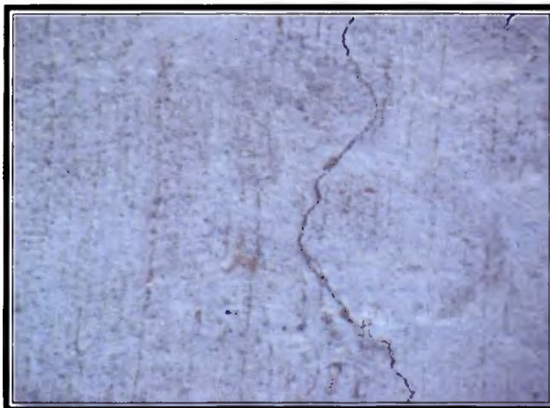
Foto 11: Grietas en losa de los pasillos
