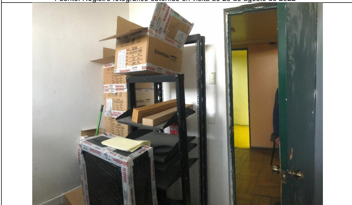
Imagen N° 2: Sala de servidores de la Municipalidad de Puerto Varas Fuente: Registro fotográfico obtenido en visita de 29 de agosto de 2022
