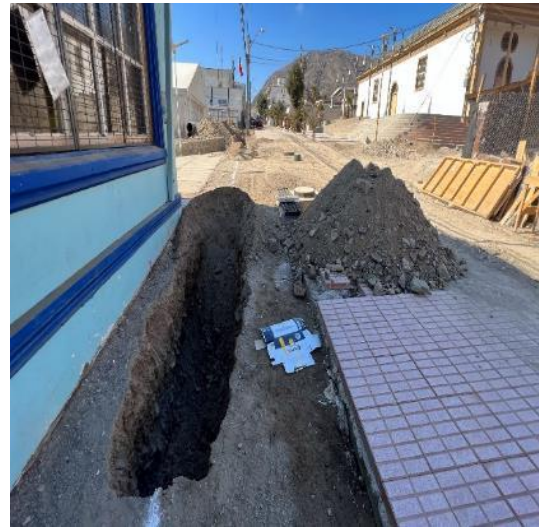
Imagen N°: 16 Fecha captura: 16 de junio de 2023. Ubicación: Calle Carrera, Chañaral. Contenido: Tramo para la instalación de una tubería en proceso de excavaciones.
