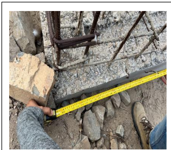
Imagen N°: 4 Fecha captura: 2 de junio de 2023. Ubicación: Estanque de acumulación de agua. Contenido: Modificación de la geometría y disposición del estanque proyectado.
