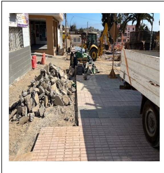
Imagen N°: 12 Fecha captura: 16 de junio de 2023. Ubicación: Calle Buin, Chañaral. Contenido: Acopio de escombros.
