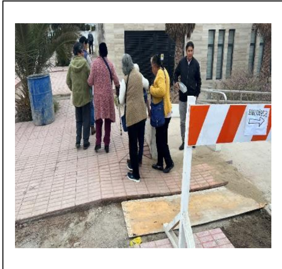
Imagen N°: 22 Fecha captura: 1 de junio de 2023. Ubicación: Calle Yungay, Chañaral. Contenido: Solución constructiva irregular.
