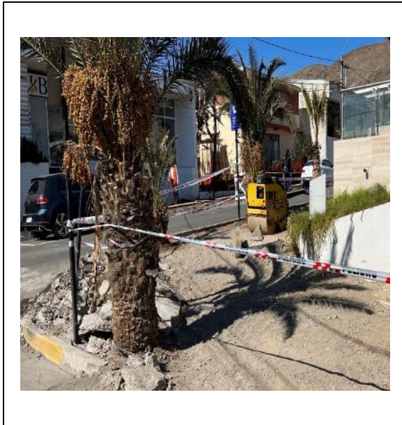
Imagen N°: 9 Fecha captura: 16 de junio de 2023. Ubicación: Calle Maipú, Chañaral. Contenido: Sectores que no han sido intervenidos con cortes de pavimento.
