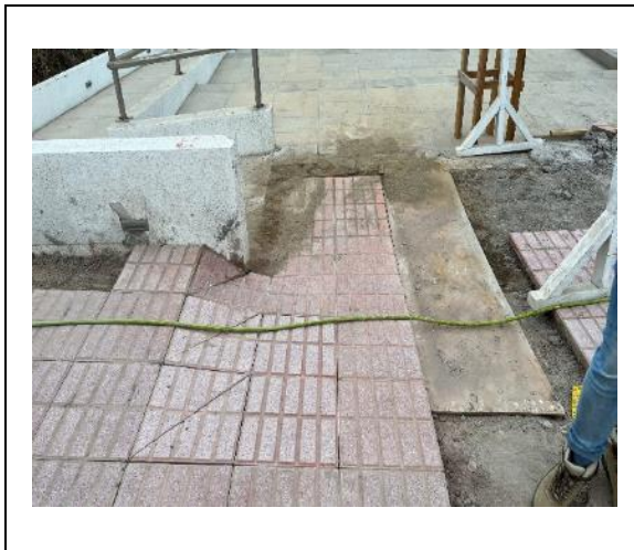
Imagen N°: 23 Fecha captura: 5 de junio de 2023. Ubicación: Calle Carrera, Chañaral. Contenido: Solución constructiva irregular.
