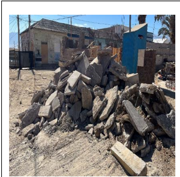
Imagen N°: 13 Fecha captura: 16 de junio de 2023. Ubicación: Calle Yungay, Chañaral. Contenido: Acopio de escombros.
