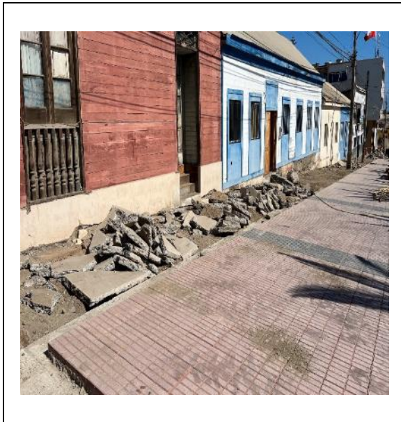
Imagen N°: 11 Fecha captura: 16 de junio de 2023. Ubicación: Calle Buin, Chañaral. Contenido: Acopio de escombros.
