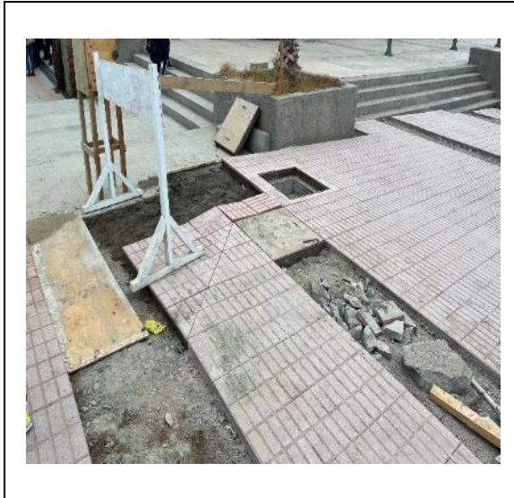
Imagen N°: 21 Fecha captura: 1 de junio de 2023. Ubicación: Calle Carrera, Chañaral. Contenido: Solución constructiva irregular.
