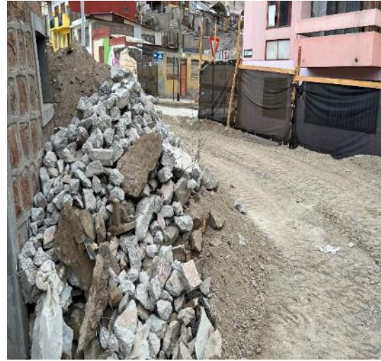
Imagen N°: 14 Fecha captura: 16 de junio de 2023. Ubicación: Calle Carrera, Chañaral. Contenido: Acopio de escombros.
