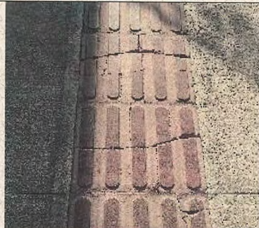
Fotografía N° 14: Baldosa fisurada calle Eleuterio Ramírez.
