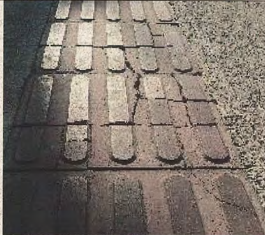
Fotografía N° 13: Baldosa fisurada calle Eleuterio Ramírez.
