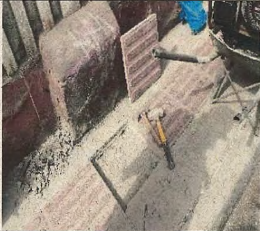
Fotografía N° 15: Baldosa en reposición sin retirar mortero. Calle José Ignacio Zenteno
