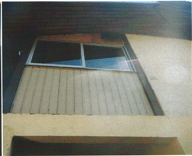
Foto N° 4 Frontón sin revestimiento
