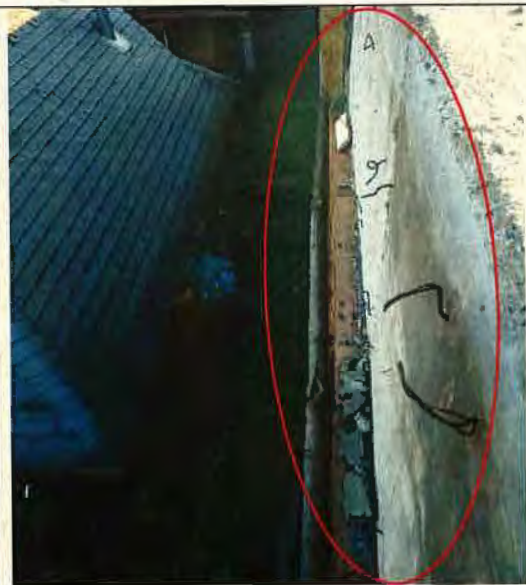
Fotografía N° 2: Altura de aproximadamente 6 metros del muro de contención, el cual supera la altura de la casa adyacente.
