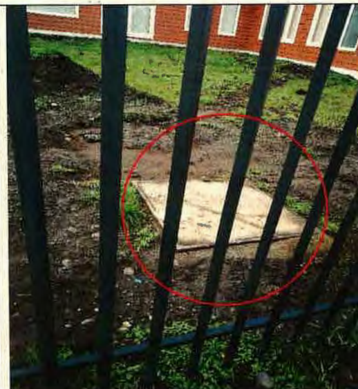
Fotografía N° 2: Conexión irregular a la red de alcantarillado.
