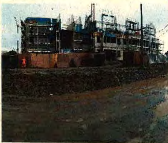
Fotografía N° 1: Falta de medidas de mitigación
