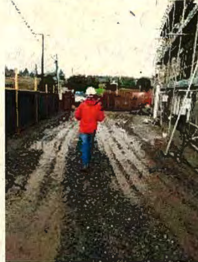
Fotografía N° 2: Falta de medidas de mitigación.
