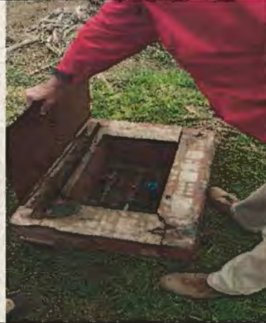
Fotografía N°20 - 09/06/2017 - Paseo Víctor Farías Tapa de sistema de riego en mal estado y sin candado
