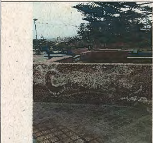
Fotografía N°31 - 09/06/2017 - Plaza Bicentenario Rayado de grafiti en muro sector nororiente
