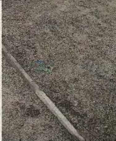
Fotografía N°22 - 09/06/2017 - Paseo Víctor Farías Sistema de riego no operativo en sector jardineras
