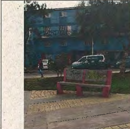
Fotografía N°6 -06/06/2017-Parque Nicolás Tirado Escaños de hormigón rayados con grafiti sector centro
