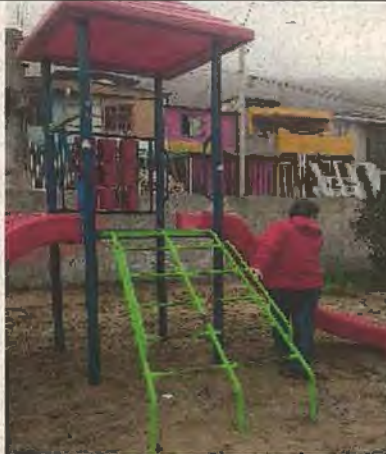
Fotografía N°24 - 09/06/2017 - Paseo Los Pumas Mal estado de pintura de juegos infantiles sector sur
