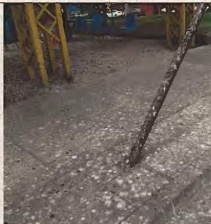
Fotografía N° 12 - 06/06/2017- Parque Brasil Guano de aves en aceras peatonales sector sur.
