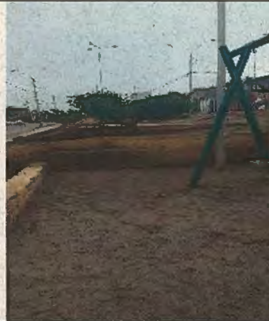
Fotografía N°26 - 09/06/2017 - Paseo María Elena Falta de pintura en solera sector norte
