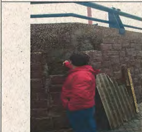
Fotografía N°29 - 09/06/2017 - Plaza Bicentenario Falta de revestimiento de muro de contención sector norte
