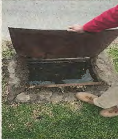
Fotografía N°23 - 09/06/2017 - Plaza Bicentenario Cámara de riego con filtración, sin aseo y tapa sin candado
