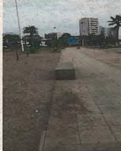
Fotografía N°22 - 06/06/2017 - Parque La Almeja Falta de limpieza en zona de tránsito peatonal e sector poniente.
