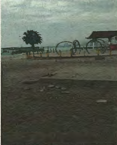
Fotografía N°21 - 06/06/2017 - Parque La Almeja Restos de escombros de solera en mal estado.
