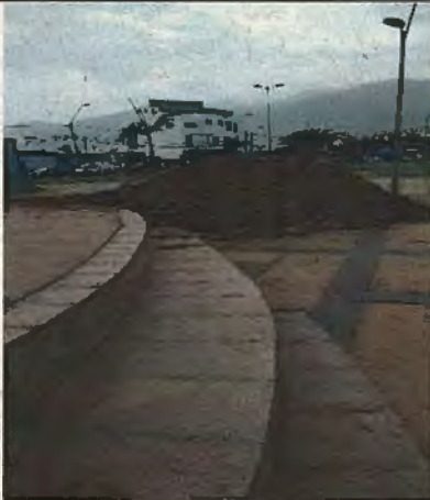
Fotografía N°15 -06/06/2017-Parque Nicolás Tirado Montículos de material en sector sur.
