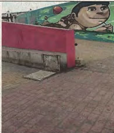
Fotografía N°17 -06/06/2017-Parque Nicolás Tirado Restos de escombros de solera en mal estado sector poniente.
