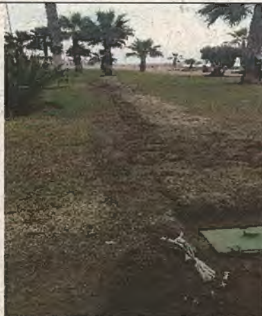
Fotografía N°16- 06/06/2017 - Parque La Almeja Instalación de sistema de regadío automático deja en malas condiciones el césped
