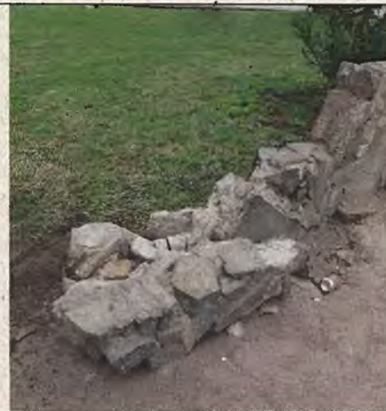
Fotografía N° 10 - 06/06/2017- Parque Brasil Restos de escombros de soleras.
