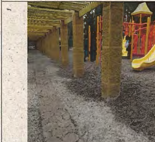
Fotografía N° 9 - 06/06/2017- Parque Brasil Falta de barrido de gravilla en paseo peatonal.
