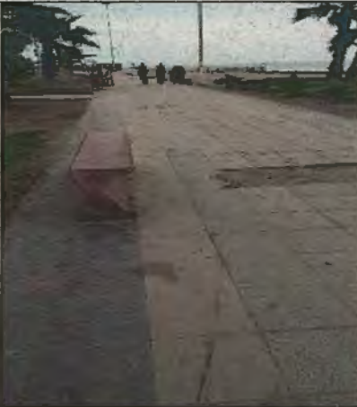
Fotografía N°23 - 06/06/2017 - Parque La Almeja Falta de limpieza en zona de tránsito peatonal en sector poniente.
