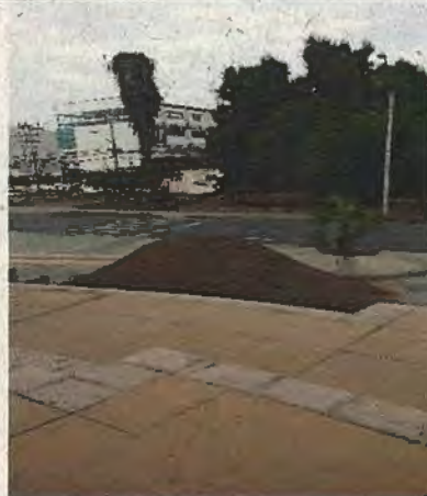
Fotografía N°14 -06/06/2017- Parque Nicolás Tirado Montículos de material en sector sur.
