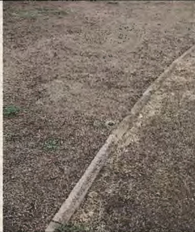
Fotografía N°19 - 09/06/2017 - Paseo Víctor Farías Sistema de riego no operativo en sector jardineras
