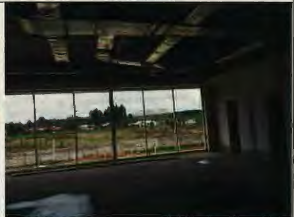
Fotografía N° 6: Sala de musculación sin pavimento de terminación
