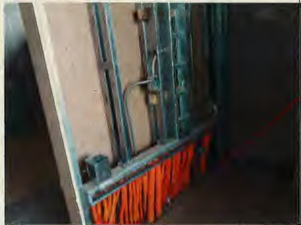
Fotografía N° 4: Tabique interior sin revestimiento
