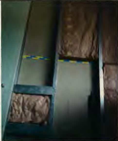
Fotografía N° 3: Tabique interior sin revestimiento
