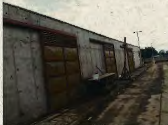
Fotografía N° 15: Puertas metálicas con oxidación
