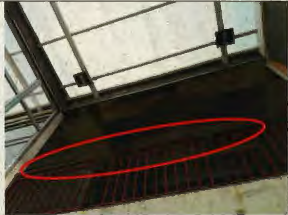
Fotografía N° 14: Elemento metálico con oxidación
