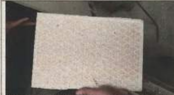
Fotografía N° 9: Cerámica de cocina retirada intacta tras la humedad sin rastros de mortero de pega
