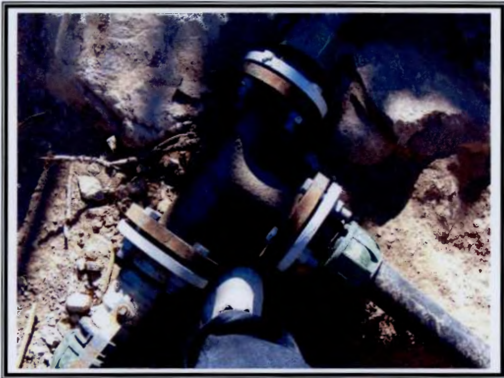
Existencia de filtraciones en la red
