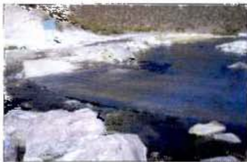
Fotografía N° 10. Vista general del badén, no se aprecian los gaviones.
