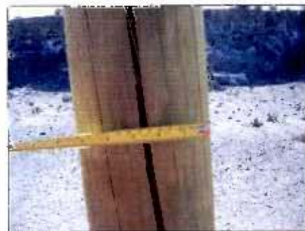
Fotografía N° 12. Grietas en el poste de madera.
