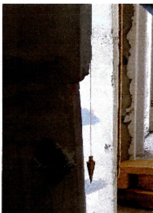
Fotografía N° 18: Desaplome en muros interiores de edificio administración, Zona A.
