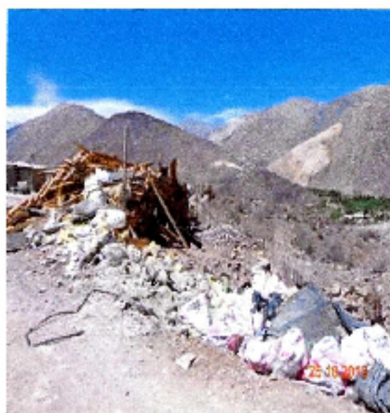
Fotografía N° 30: Escombros y basuras en la obra.
