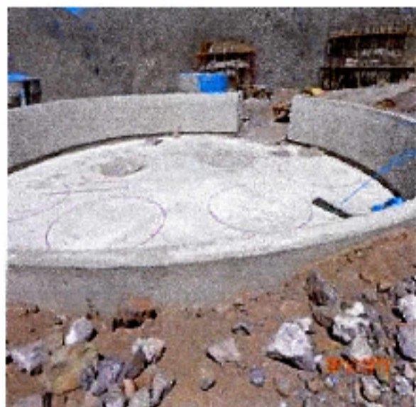
Fotografía N° 12: No se han ejecutado partidas de terminaciones en plaza mirador de Zona C.
