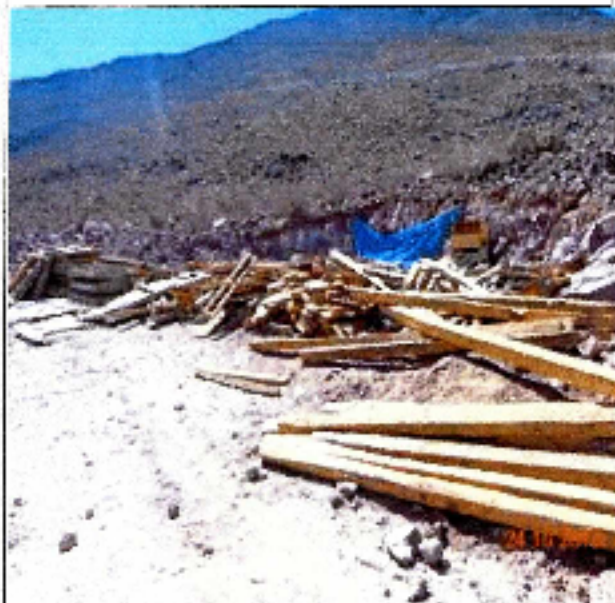
Fotografía N° 32: Basura, maderas de moldajes y despuntes dispersos en la obra.
