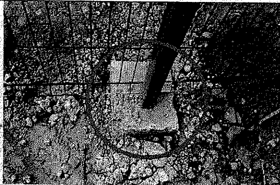
Fotografía N° 9: Pérdida de geometría de la fundación de hormigón del poste del cerco perimetral.
