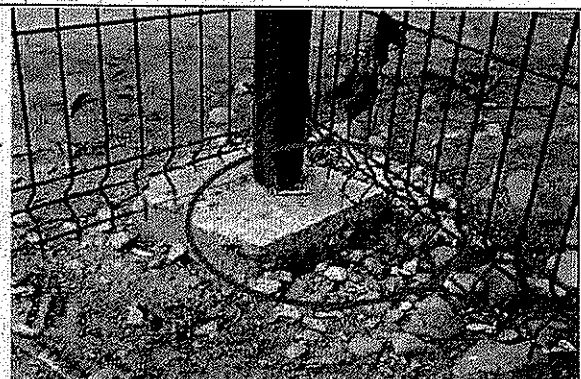
Fotografía N° 8: Segregación en la fundación de hormigón del poste del cerco perimetral.
