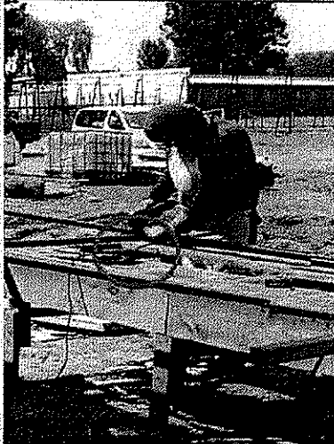
Fotografía N° 25: Trabajador utilizando un disco de corte sin casco y sin que la herramienta cuente con la protección para ese trabajo.
