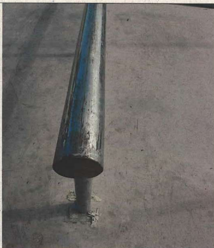
Imagen 6. Deterioro en instalaciones.
