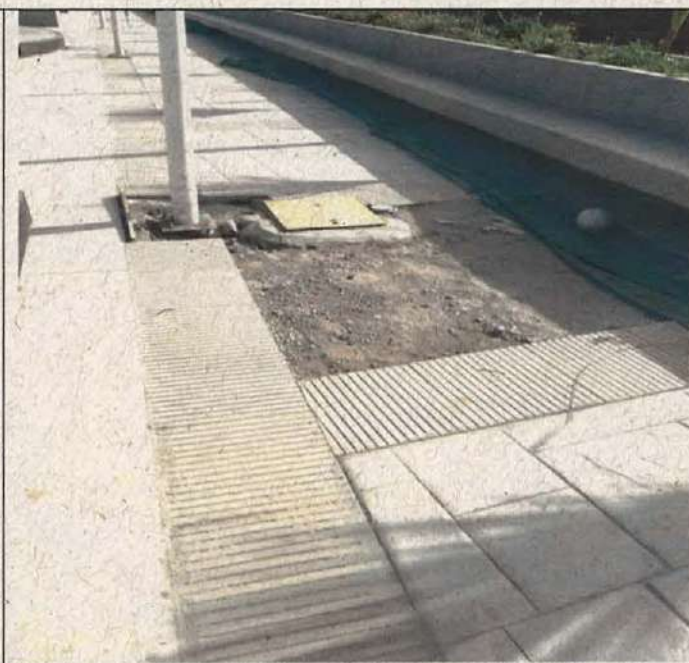
Imagen 4. Poste eléctrico sin base, falta instalación de baldosas.
