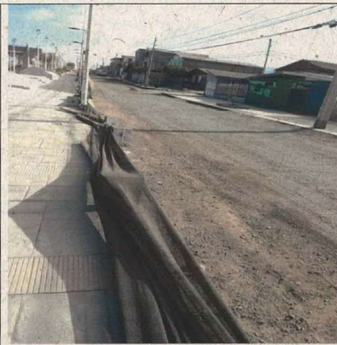
Imagen 2. Calzada sin avance y cierre perimetral en malas condiciones.
