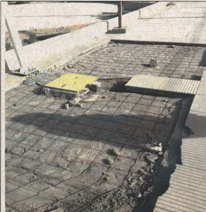
Fotografía N°13. Falta de instalación de baldosas y deterioro de las mismas.
