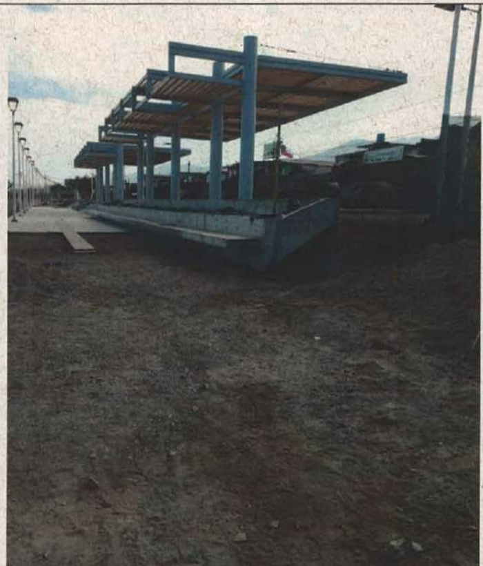
Fotografía N°18. Falta instalación de baldosas.
