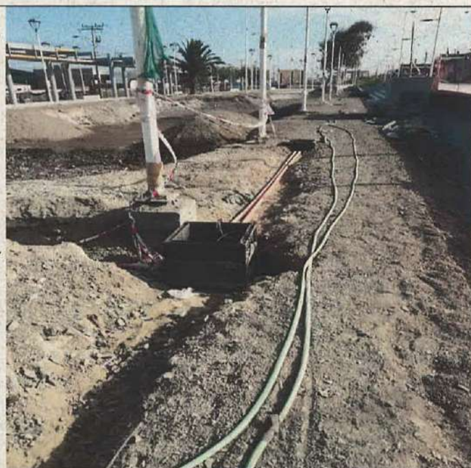
Imagen 8. Cámaras eléctricas sin terminar y tuberías a la vista.
