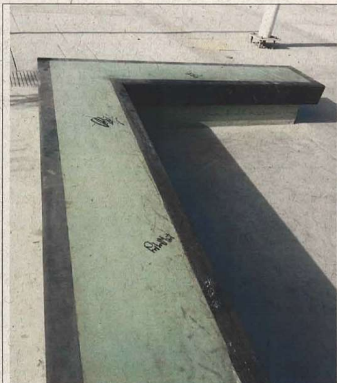
Imagen 5. Deterioro en instalaciones.
