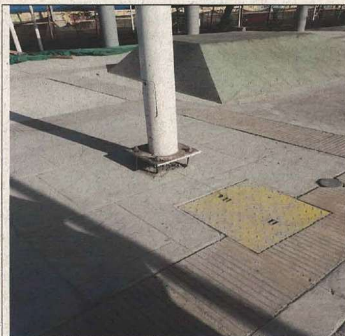
Imagen 3. Postes eléctricos sin base.
