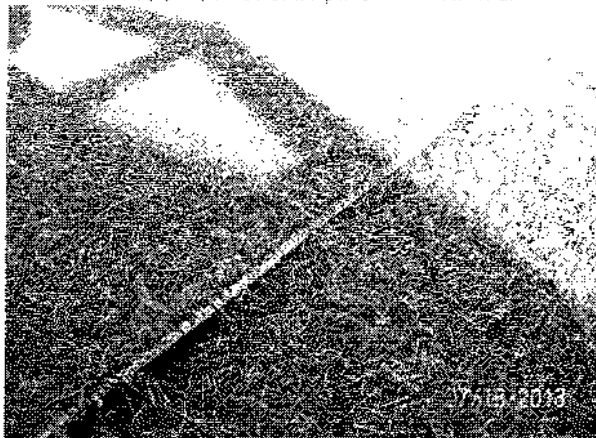
Fotografía N°19 Uniones deficientes y visibles entre paños de la cancha.
