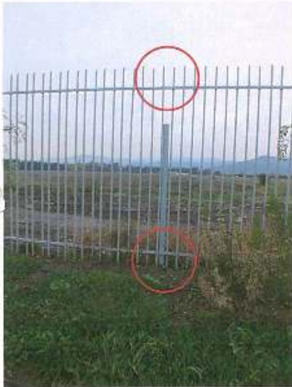
Foto N°1 Pilar corto, no alcanza segundo punto de apoyo
