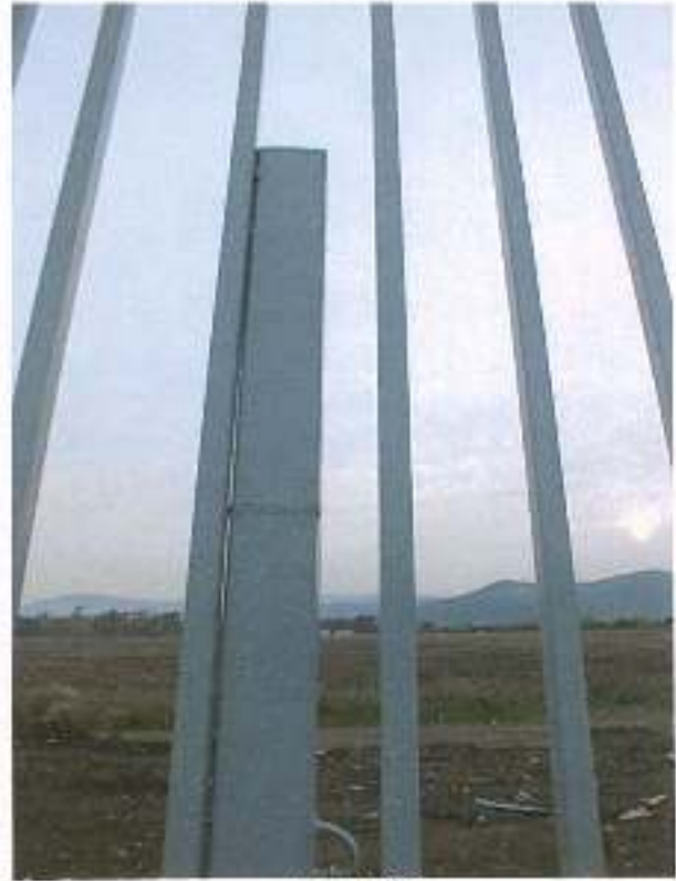
Foto N°2 Detalle soldadura a barra vertical, no a horizontal
