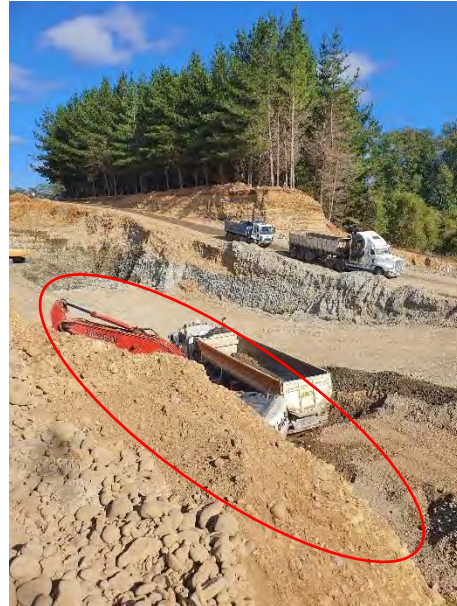
Fotografía N° 9: Falta señalización peligro de caídas y derrumbes.
