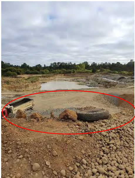
Fotografía N° 10: Falta señalización peligro de caídas y derrumbes.
