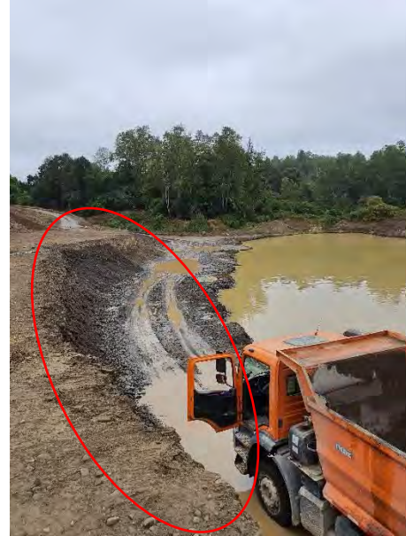
Fotografía N° 5: Falta señalización peligro de caídas y derrumbes.
