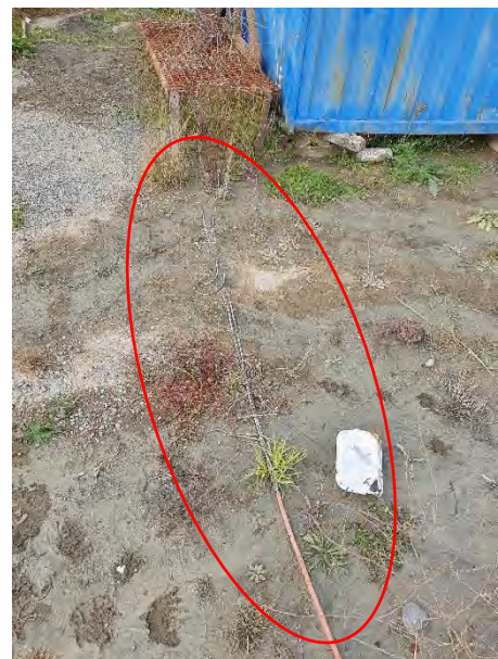
Fotografía N° 15: Conductores eléctricos sobre el suelo.
