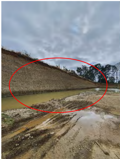
Fotografía N° 6: Falta Señalización peligro de caídas y derrumbes
