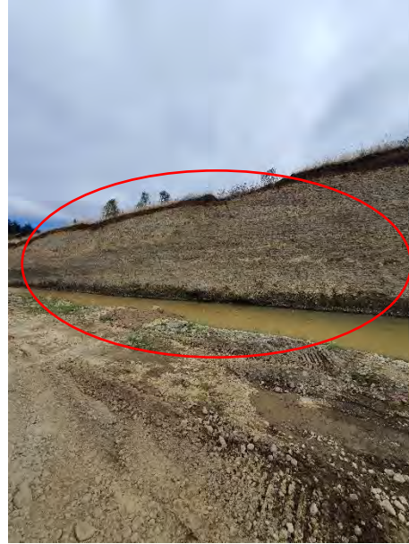
Fotografía N° 5: Falta señalización peligro de caídas y derrumbes
