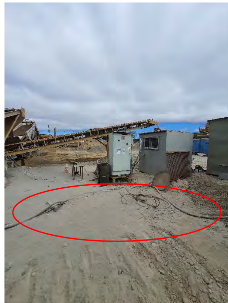
Fotografía N° 7: Conductores eléctricos sobre el suelo
