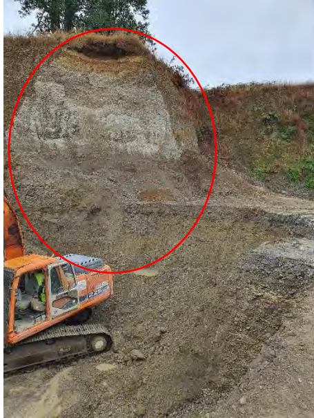
Fotografía N° 4: Falta señalización peligro de caídas y derrumbes.
