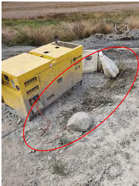
Fotografía N° 14: Conductores eléctricos sobre el suelo.
