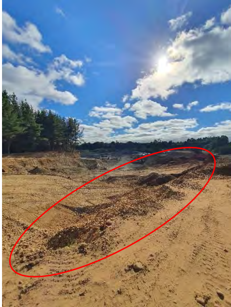
Fotografía N° 8: Falta señalización peligro de caídas y derrumbes.
