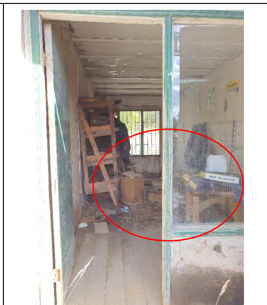
Fotografía N° 3: Contenedor- bodega en faena- acumulación de residuos y basura al interior.
