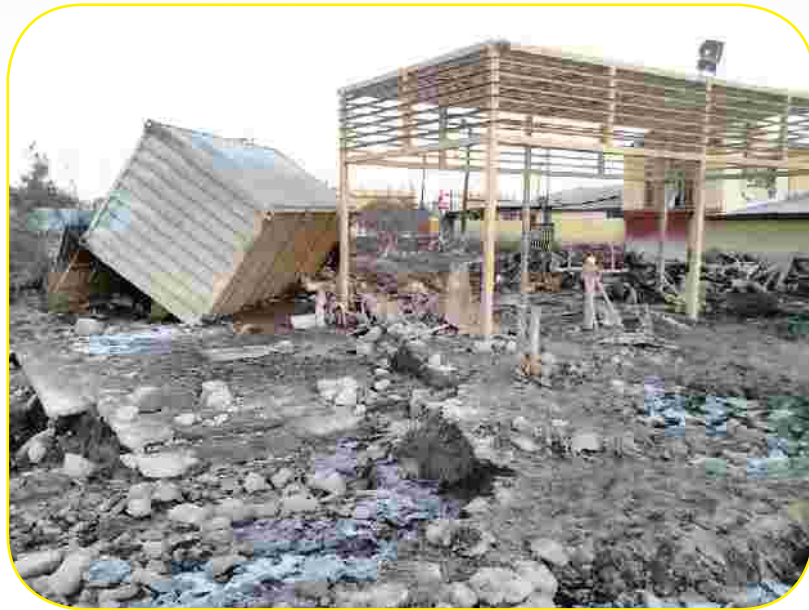
ESCOMBROS EN LA VÍA PÚBLICA.
