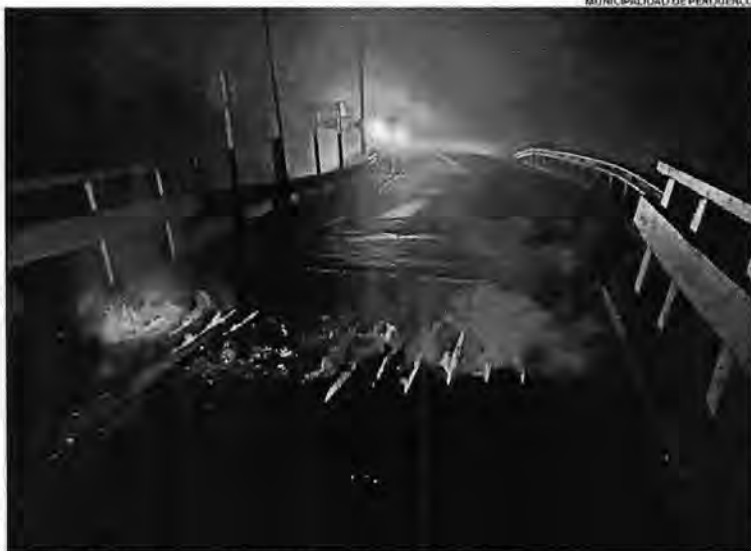
DAÑOS EN LA INFRAESTRUCTURA QUE UNE A PERQUENCO Y SELVA OSCURA.
