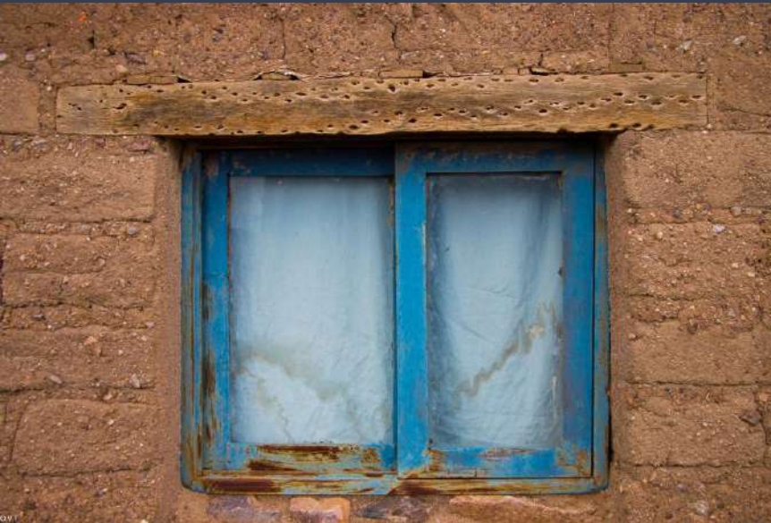
Ventana metálica, peana de piedra y dintel de madera de cactus, Chijo
