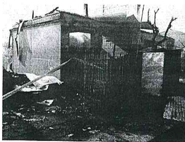
Imagen 1: Casa afectada por incendio Villa Rehuén, Mulchén 2015 Fuente: Constanza Reyes. Radio Biobío
